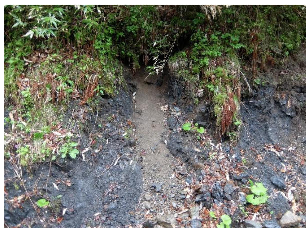
写真-6 溪岸にできた穴から流れる土砂
