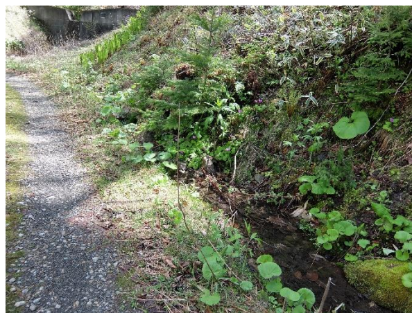
写真－13 切土のり面の崩壊で埋まった側溝
