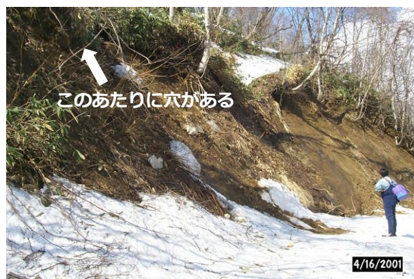
写真-5 崩落タイプがあったのり面 (融雪期における穴からの土砂流亡)
