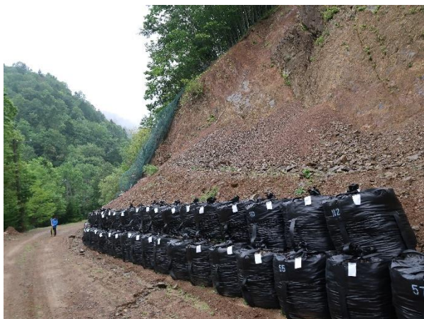
写真-9 切土のり面脚部に置かれた大型土嚢
