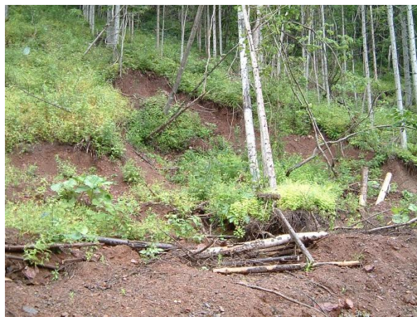
写真-3 立木ごと表層土が崩れた事例
