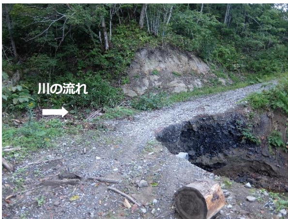
写真-9 谷をまたぐ道路における下流側での崩壊
