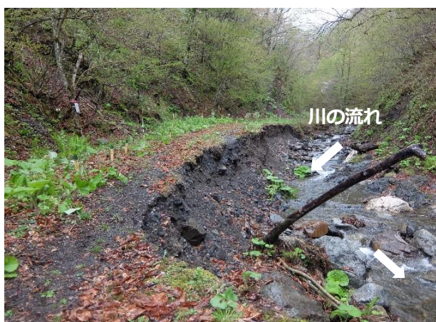
写真-6 溪岸侵食（のり面を直接侵食）
