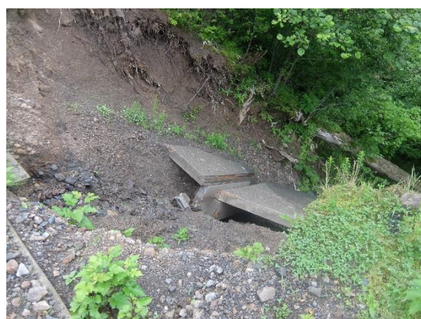
写真-5 崩落した明渠
