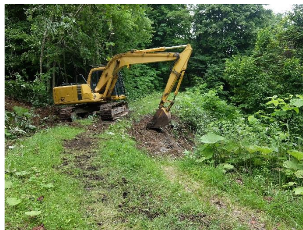
写真-16 盛土のり面崩壊の復旧(つづき)
