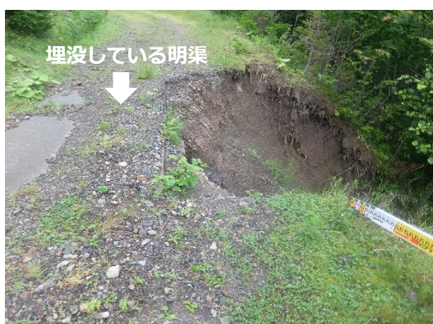
写真-4 崩落タイプ
