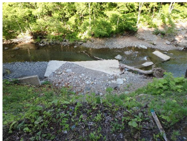
写真-12 溪岸にある擁壁の倒壊
