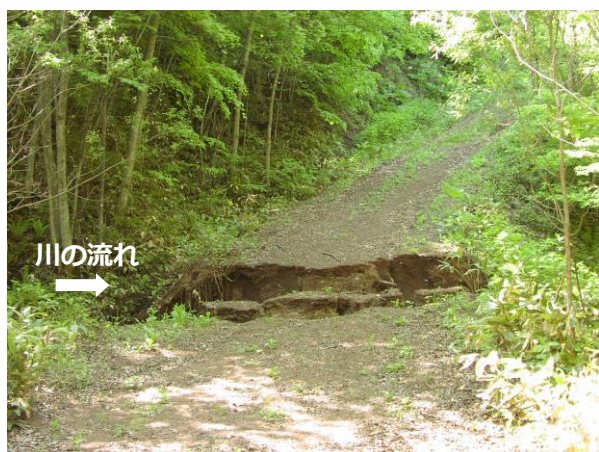
写真-4 路面に横断的な侵食
