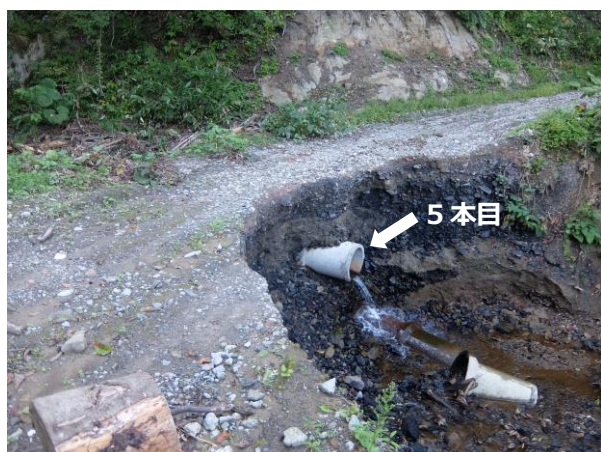
写真-8 2016年9月21日での盛土のり面崩壊
