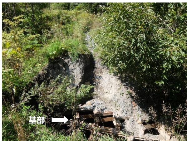
写真-6 道を支える基部が露出している
