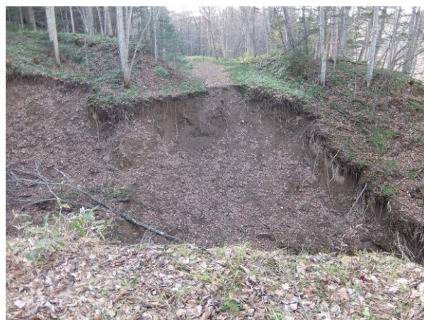
写真-1 道がなくなっている
