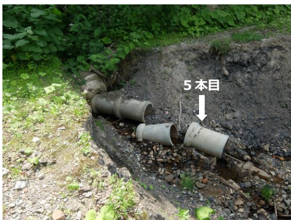
写真-11 2018年6月7日の様子（路体消失）
