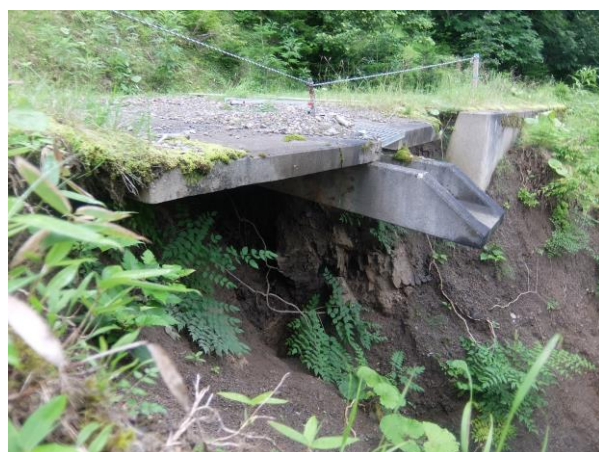
写真-5 横断排水下の路体だけが崩れた
