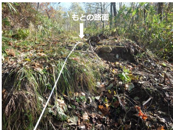
写真-7 沈み込んだ道にできた段差
