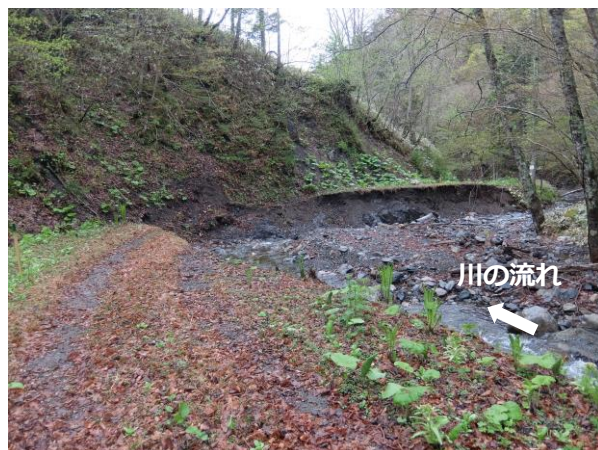
写真-3 川によってえぐられた道
