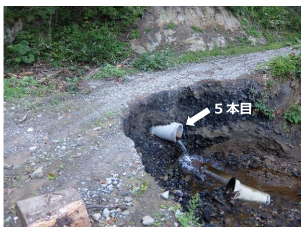
写真-8 2016年9月21日での盛土のり面崩壊
