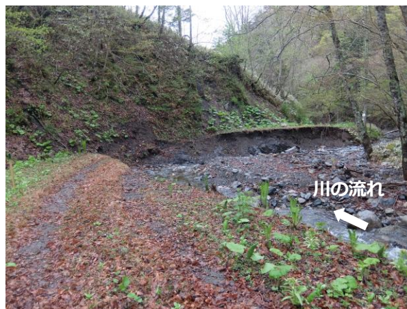
写真-3 川によってえぐられた道
