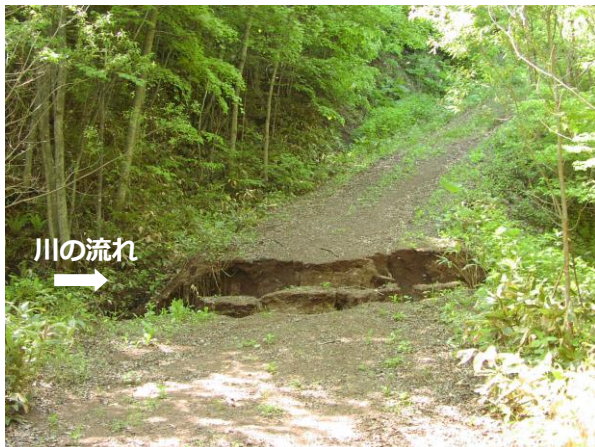
写真-4 路面に横断的な侵食
