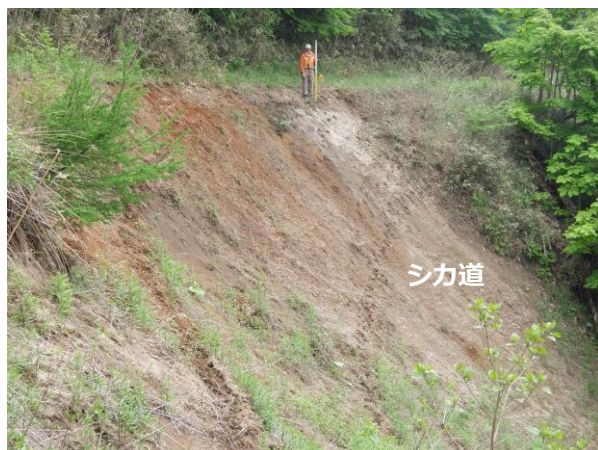
写真-2 地山ごと崩壊した道
