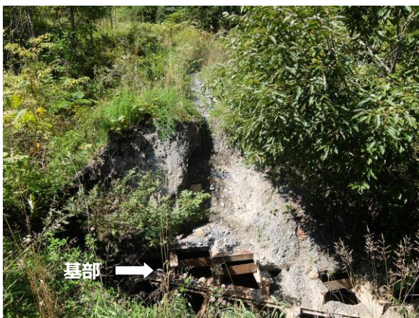
写真-6 道を支える基部が露出している
