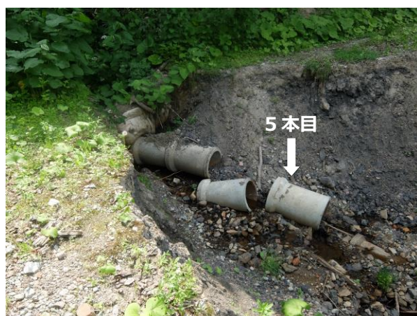
写真-11 2018年6月7日の様子（路体消失）
