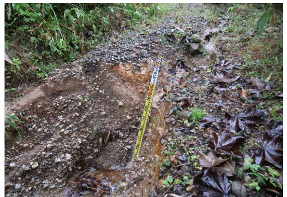
写真-3 深く掘れた路面侵食
