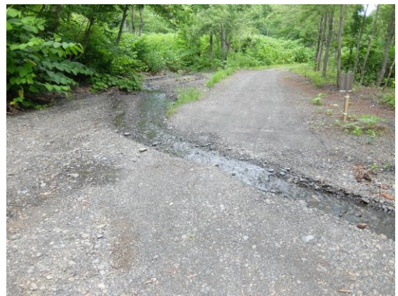
写真-5 川水による路面の削れ
