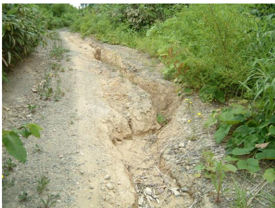
写真-1 路面にできた溝
