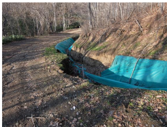
写真-20 侵食される側溝
