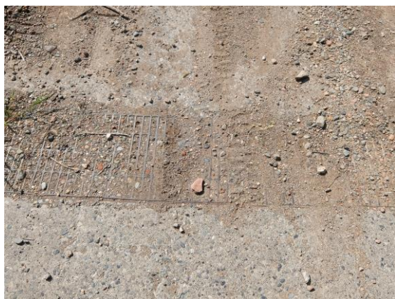
写真-19 埋没した横断排水明渠
