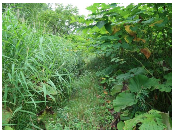
写真-22 植生が繁茂した道路
