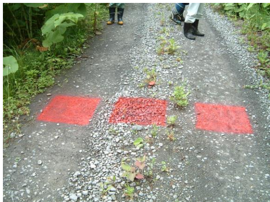
写真-14 2002年7月8日の路面の様子
