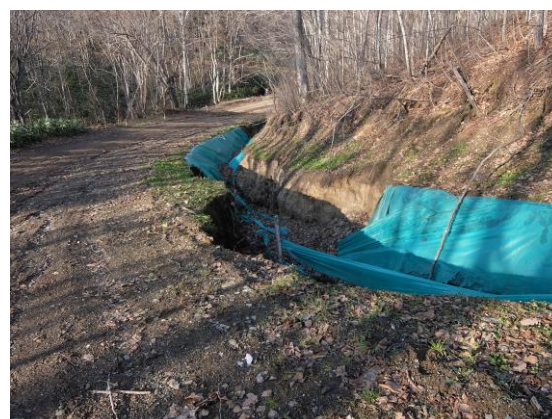
写真-20 侵食される側溝
