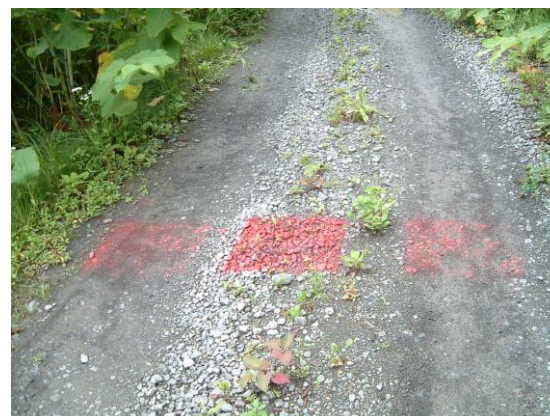
写真-15 2002年7月16日の路面の様子
