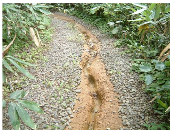
写真-13 砂利の移動と路床の削れ
