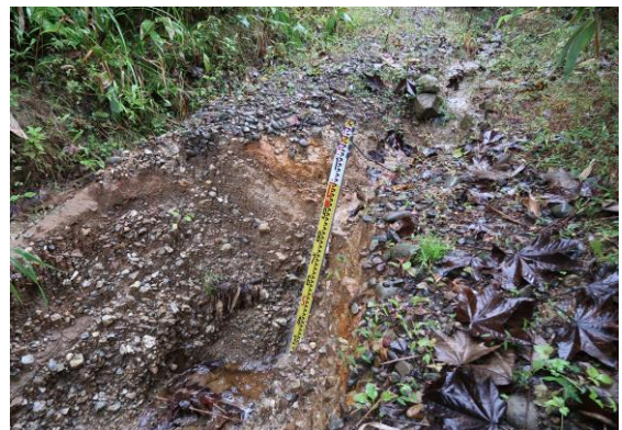
写真-3 深く掘れた路面侵食
