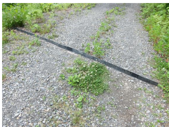
写真-17 ゴム製の止水施設
