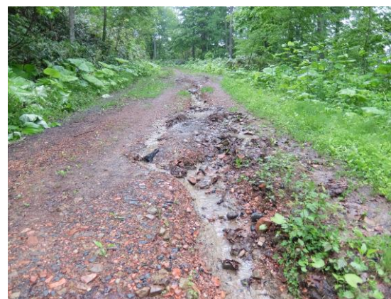
写真-7 ガリ内を流れる濁水
