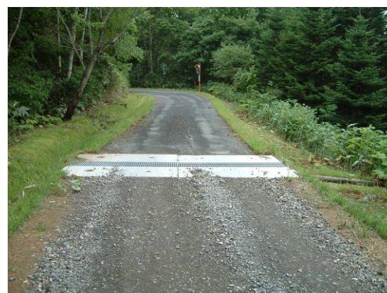
写真-18 コンクリート製横断排水溝
