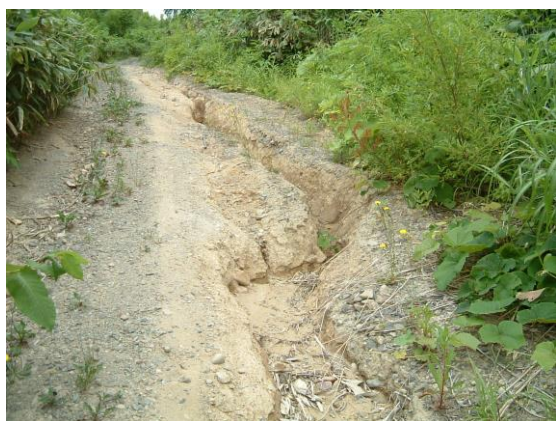
写真-1 路面にできた溝
