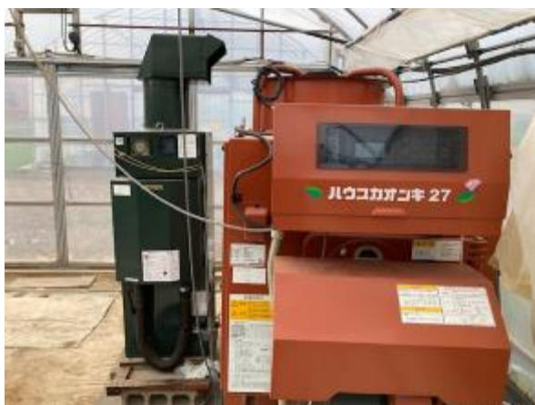
写真1 加温機（右、橙色の機器）、 CO 2 発生装置（左、濃緑色）
