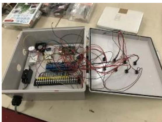
中野ら（2018）の統合環境制御盤（製作途中）
