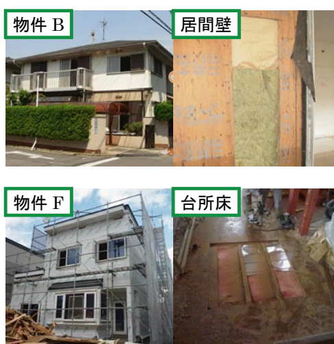
写真1 調査物件と合板採取の状況
