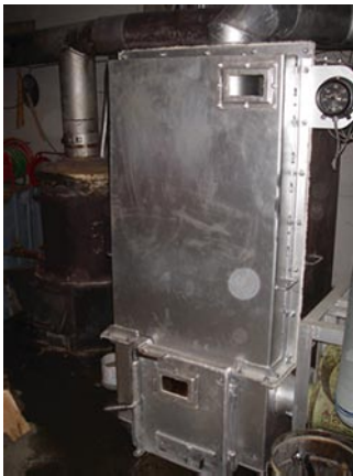
写真4 バイオマスボイラー（ペレット工場）
