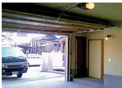
写真10 木製オーバードアの格納の様子(全開)
