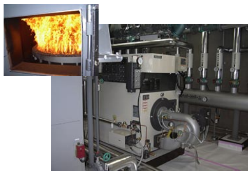
写真 2 足寄町役場新庁舎のペレットボイラー
