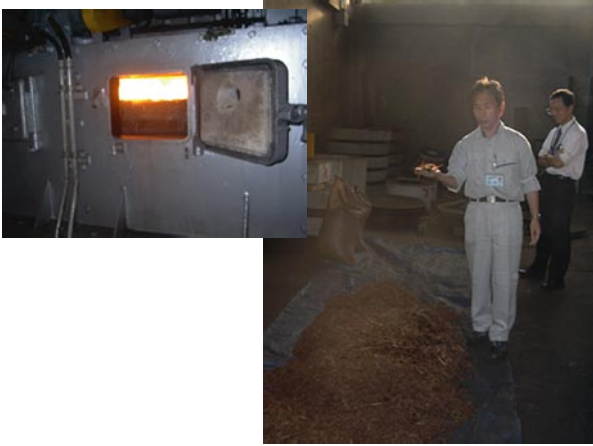
写真5 札幌市熱供給公社のバイオマス混焼試験
