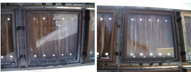
写真5 木製サッシの暴露試験 (半造膜タイプ北面 15年目) 左：取付後再塗装無し 右：再塗装有り
