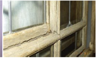
写真13 風雪で削られた棧
