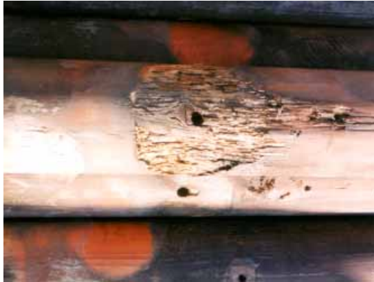
屋外遊具の組み合わせ部分の腐朽 (組み立て後塗装したため塗料が塗布されてない)
