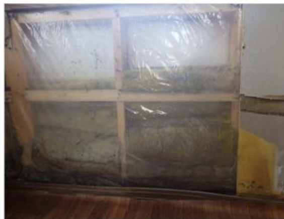
写真 2-1：床上浸水による壁内部の断熱材の吸水・脱落（H28、南富良野町）
