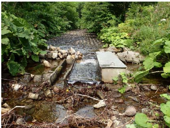
写真-1 小規模取水施設の一例（富良野市内）。 富良野市内の山地溪流。河道内に取水口を置き、 管路を引いて下流に送水している。
