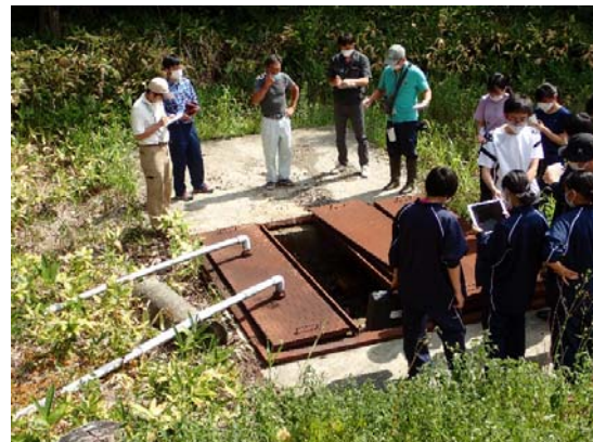
写真-2 簡易処理施設の一例。 写真1の下流地点に設置されている石濾過装置。
