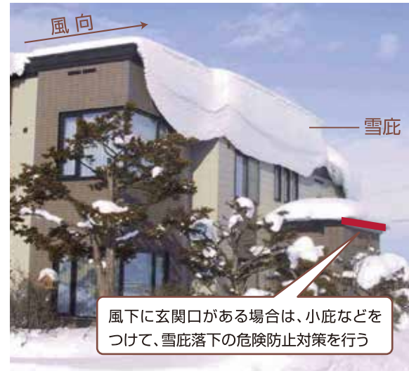
写真:9 建物の風下側に発生した雪庇
