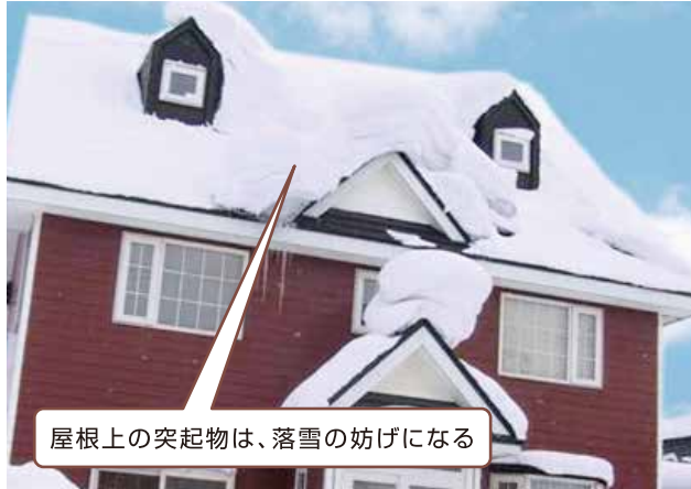
■写真:2 複雑な屋根形状での落雪障害
