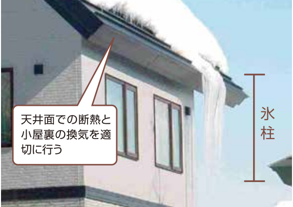
写真:5 断熱と換気不足による氷柱の発生
