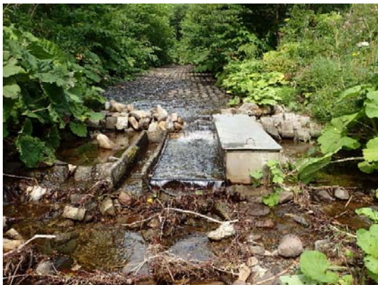
写真-1 小規模取水施設の一例（富良野市内）。 富良野市内の山地溪流。河道内に取水口を置き、 管路を引いて下流に送水している。
