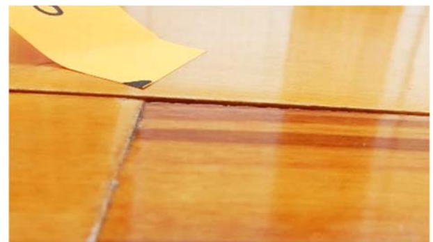
第23図 角部の沈み込みによる段差（施設C 2021年9月）
