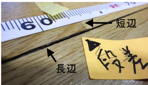
第22図 短辺がある側のフローリングが高い段差（施設B 2021年1月）
