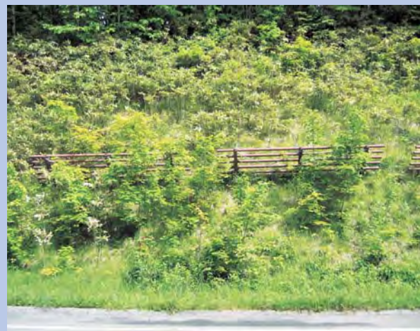
写真-3 自生植物の法面への侵入
