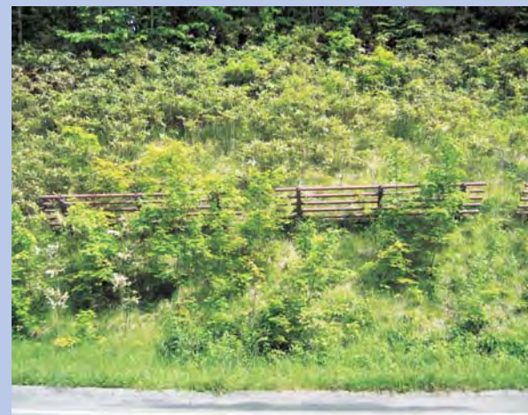
写真-3 自生植物の法面への侵入
