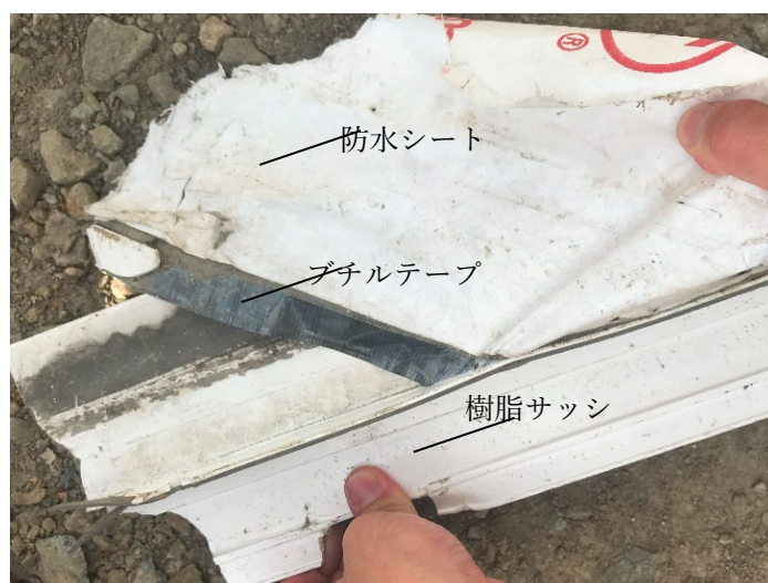
図4 樹脂サッシと防水シートの接着部分（A社）
