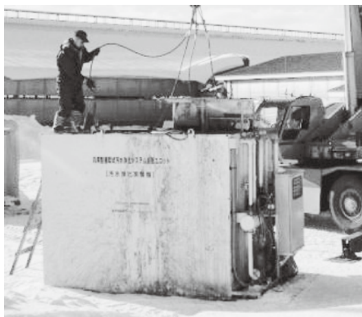
試験装置の現場設置風景
