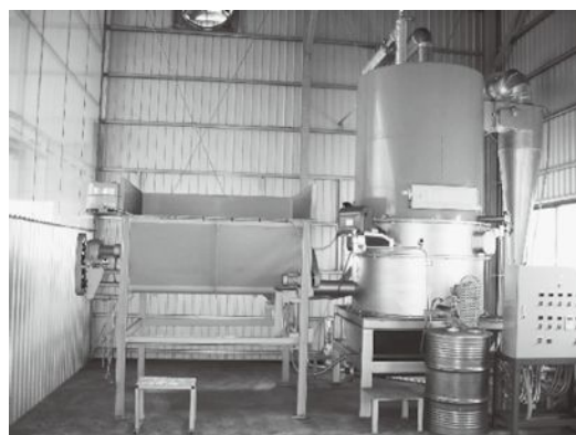
廃菌床を燃料としたボイラー
