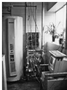
ヒートポンプユニット
