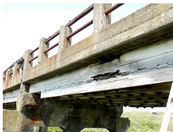
図 10 木桁の腐朽劣化の様子
