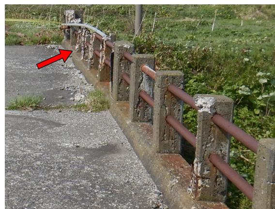
図7 劣化が進んだ高欄の様子
