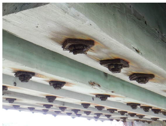
図5 塩害を受けた木桁下面のボルト・ナット
