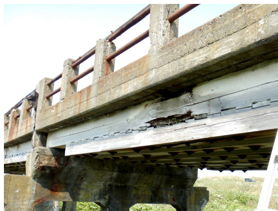
図 10 木桁の腐朽劣化の様子
