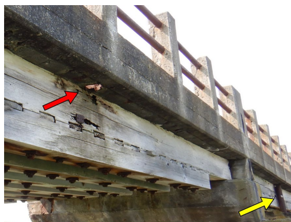
図 11 排水管の残留箇所(黄)と脱落箇所(赤)
