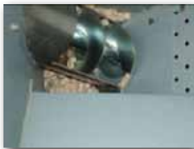
搬送装置の詰まり
