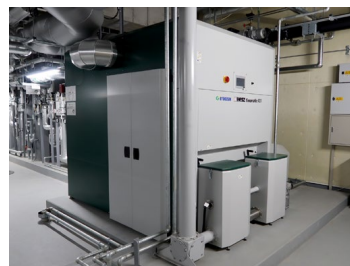
図6 木質バイオマスを利用した 暖房システム
