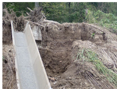
図2 白糠町タンタカの土砂侵食 谷の出口に広がる過去の土砂流堆積物に施工されている排水溝の脇で顕著な侵食が生じた。
