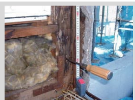
図1 壁体内の腐朽 1)
