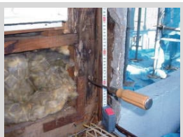
図1 壁体内の腐朽 1)
