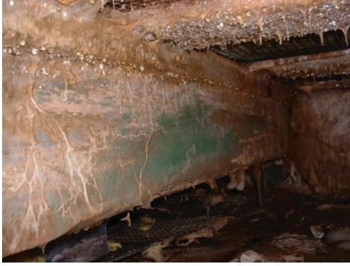
生物劣化の様子
