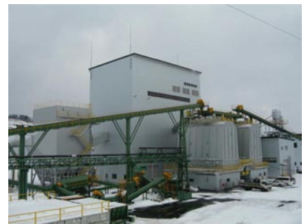
＜バイオマス発電施設＞
