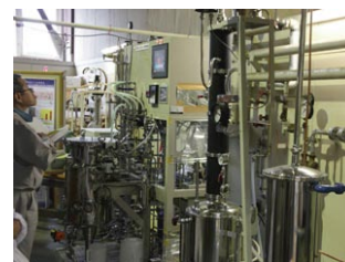
発酵蒸留装置
