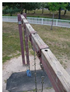
写真6 水平部材の劣化
