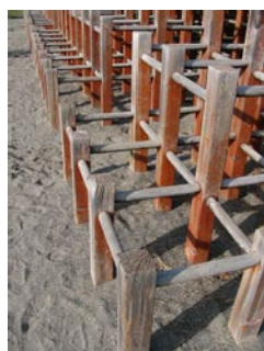
写真5 柱頭木口の劣化
