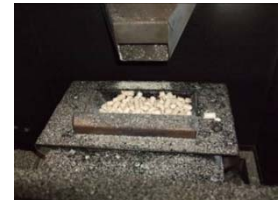
写真2 オーバーフロー ※着火不良などが原因
