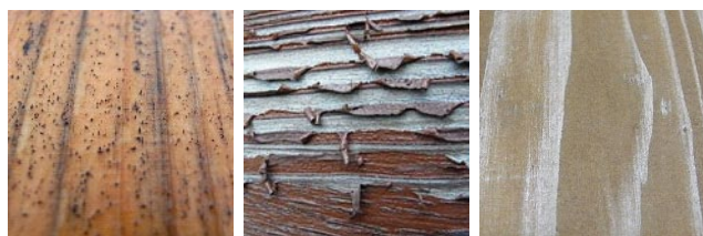
塗膜表面のカビ 厚い塗膜の劣化 薄い塗膜の劣化
