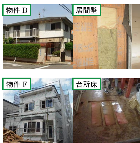
写真1 調査物件と合板採取の状況
