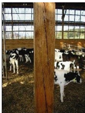
写真1 畜舎構造材の割れ
