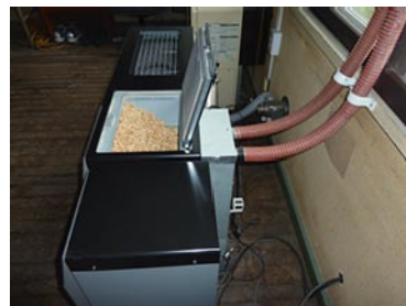
写真3 ペレットストーブ (横から)
