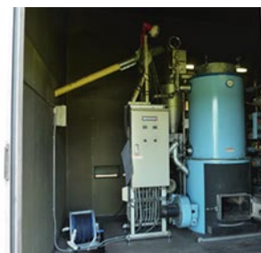
写真8 ペレットボイラの外観
