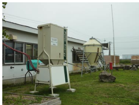
写真4 屋外サイロの外観 (手前：空送方式、奥：スクリーコンベア方式)
