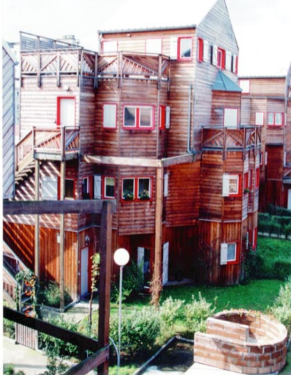
写真1 外装仕上げ材の変色
