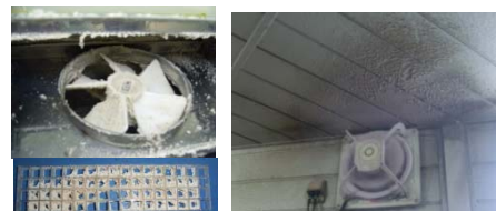
汚濁した加湿器内部のファン 汚濁した換気扇と天井部
