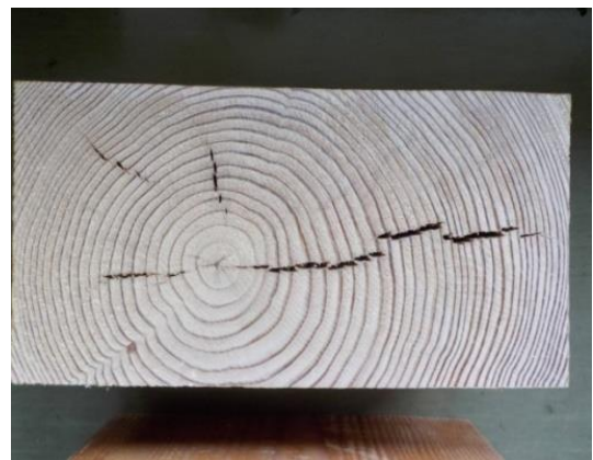
写真2 乾燥により生じた内部割れ
