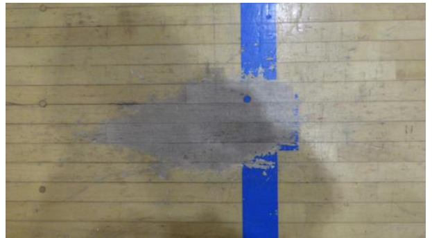
写真10 ゴールの運搬、設置による塗装剥がれと損傷
