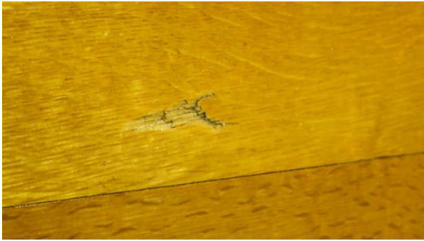
写真5 ササクレ状になった基材のはく離
