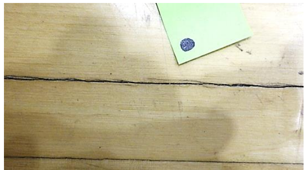
写真23 目地部分の細かな割れ
