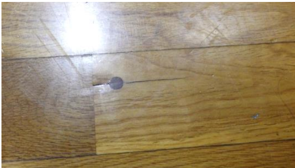
写真20 収縮膨張による端部の割れ
