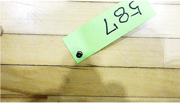
写真24 写真23と同じ目地の延長で発生した割れ
