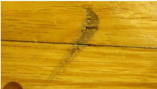
写真6 引きずりによる基材の露出
