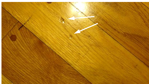
写真1 落下物による凹み
