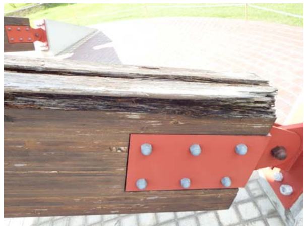
図3 脚部の腐朽（2017年）
