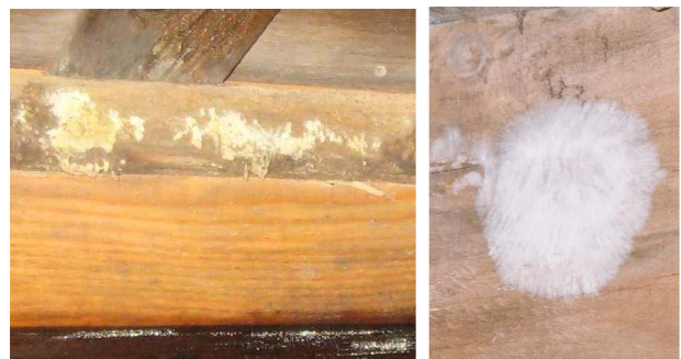
写真3 床下で発生した菌類
