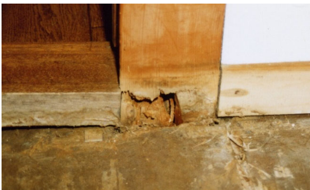
写真1 畳で隠れた部分に発生した腐朽事例
