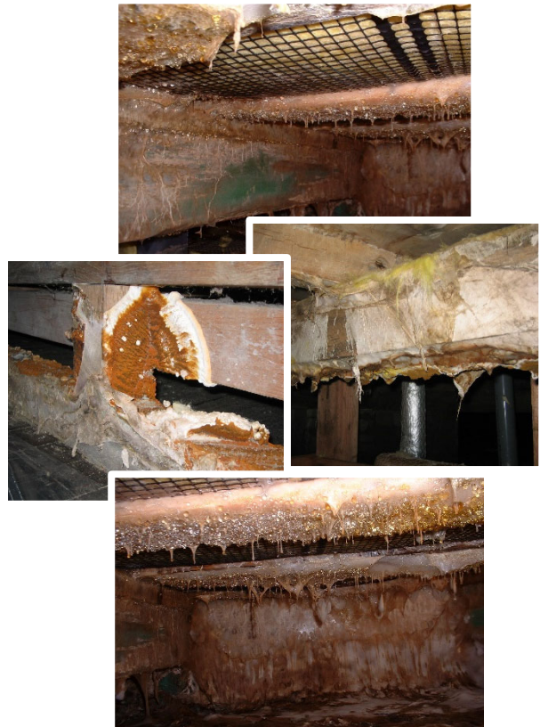
写真2 床下で腐朽菌が蔓延した事例
