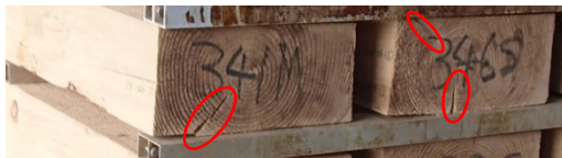
図2 木口からの表面割れ
