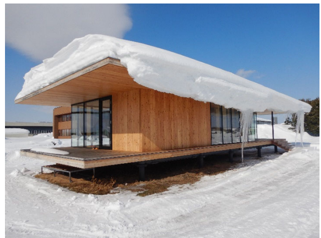
写真3 東側に形成された雪庇（2021年3月4日撮影）
