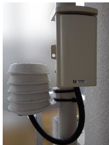
図5 ベランダへの設置状況
