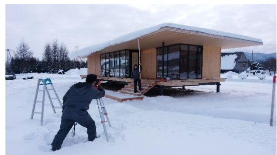
図4 屋根パネルの変形測定
