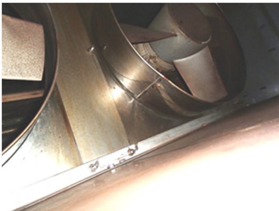
写真6 室内空気循環用ファン
