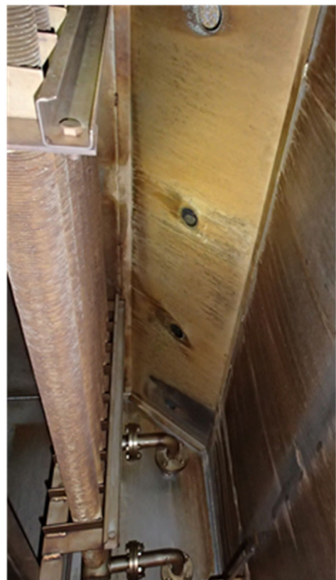
写真9 上部整流板の通気孔
