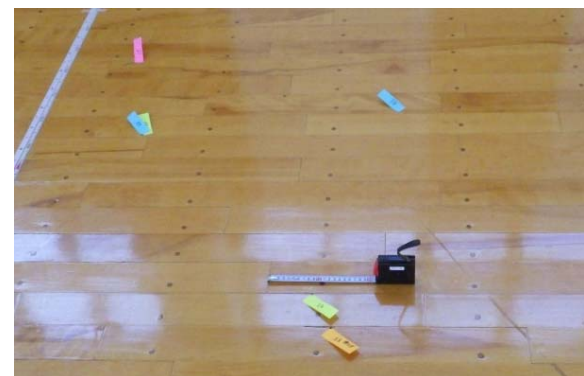
写真8 損傷発生箇所の付箋
