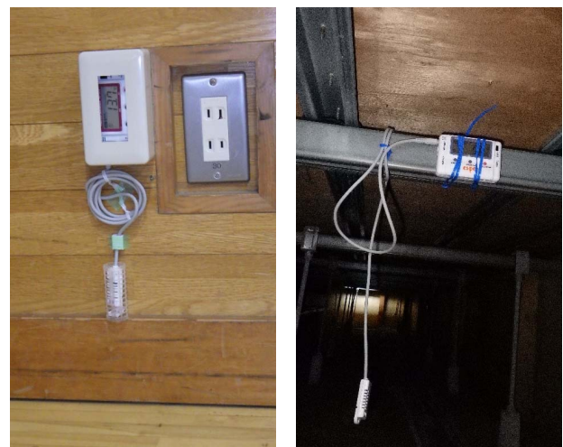
写真1 温湿度データロガーの設置例 床上（左）と床下（右）
